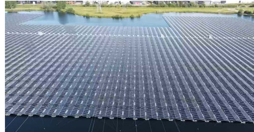
Solarpark Sekdoorn (15 MW, Niederlande)
