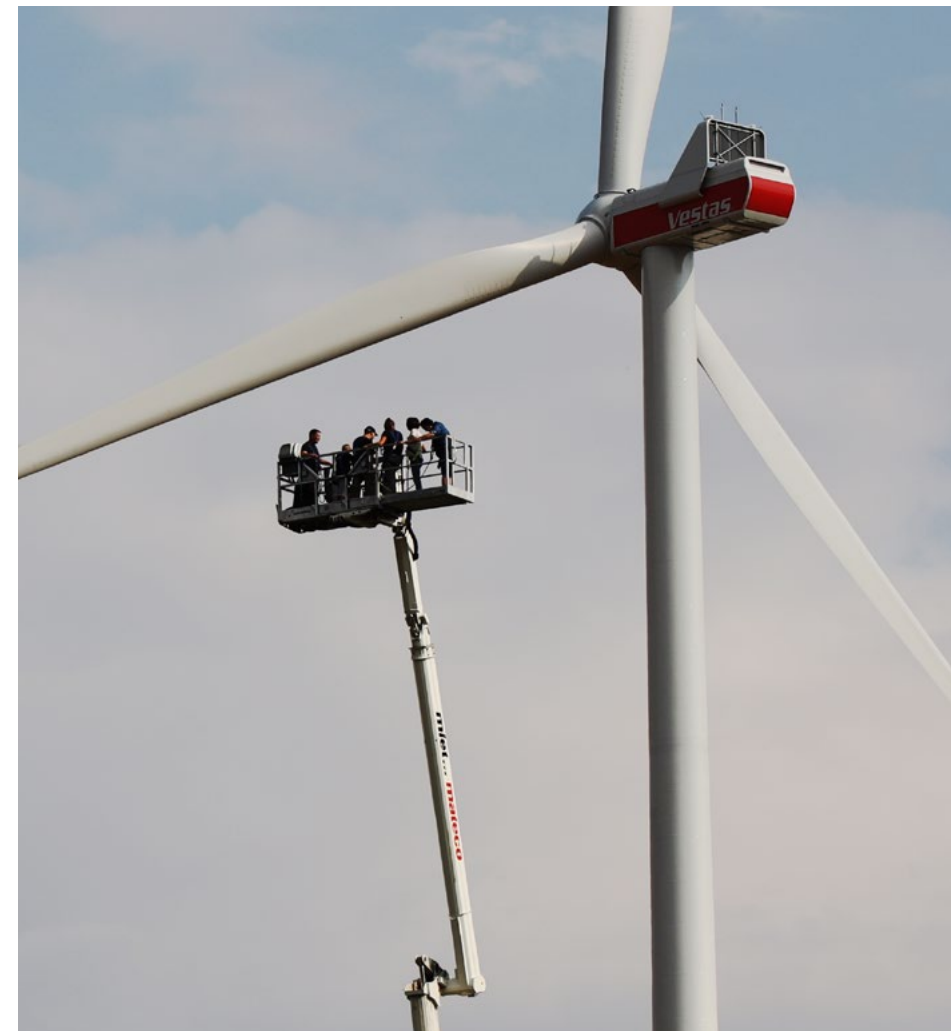
Windpark Gieboldehausen (28,5 MW, Deutschland)
