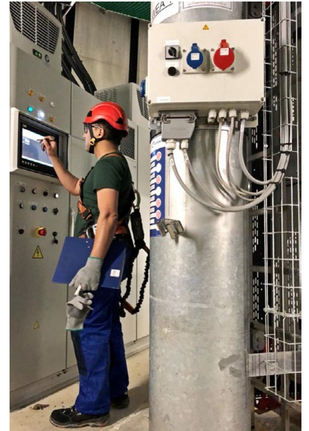
Inspektion und Leistungskontrolle im Windpark
