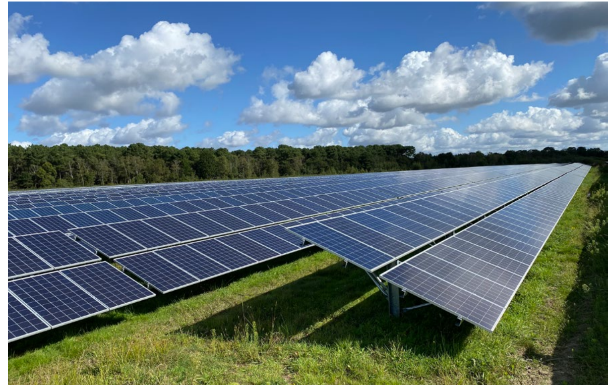
Solarpark Sonzay (10,7 MWp, Frankreich)
